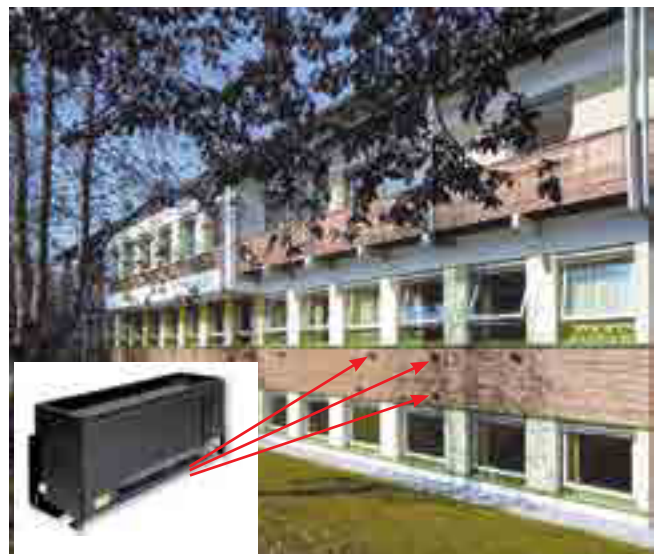
■ Nachrüstung an einer Schule am Chiemsee von außen. Unten li. ein Mustergerät vergleichbar mit einem Elektrospeichergerät.
