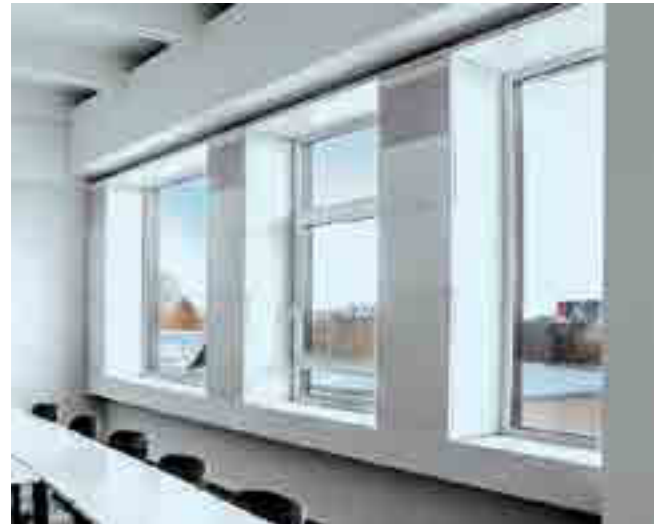
■ Trox Nachrüstungen zwischen den Fenstern im Innenraum
